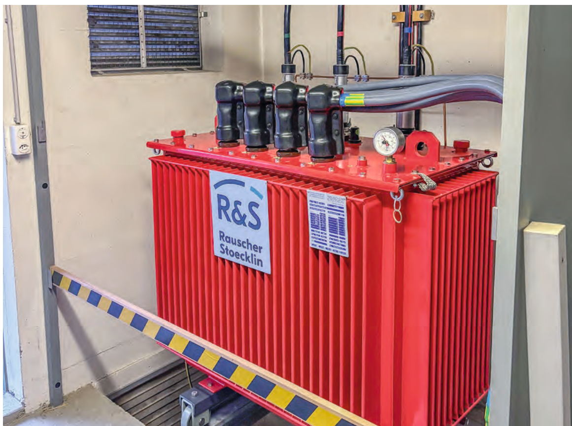
TS Höhenweg, neuer Transformator
