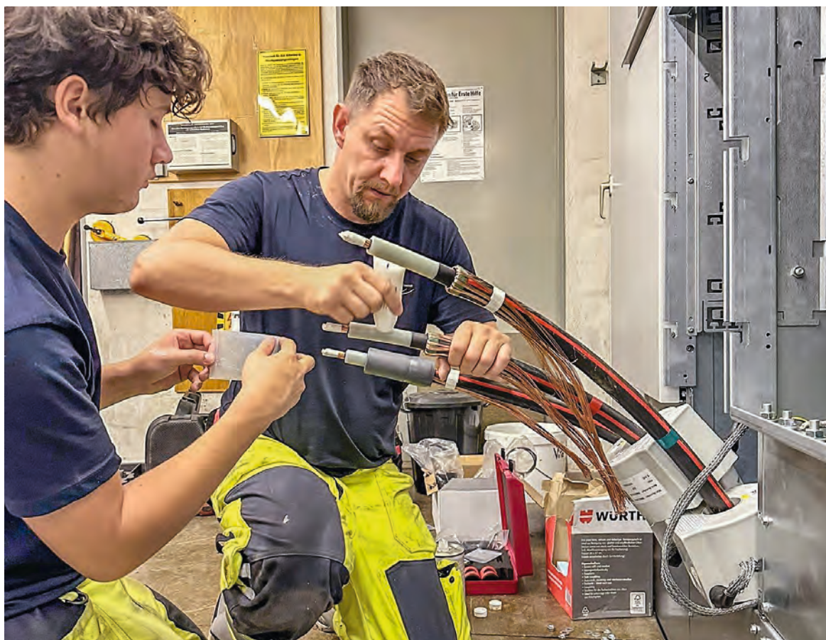
Ersatz Mittelspannungsschaltanlage TS Oederlin Nord
